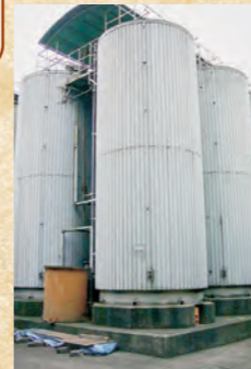
屋外発酵タンク
